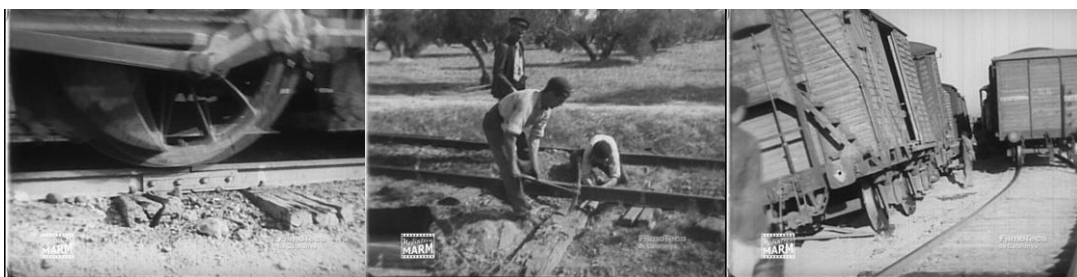
F 3, 4 y 5. Necesidad del mantenimiento de las traviesas de las vías del tren. Madera en España del marqués de Villa Alcázar
