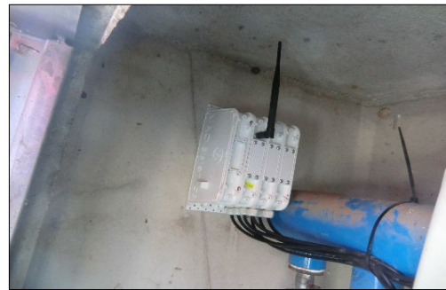
Ilustración 13: Ejemplo de unidad remota instalada en el interior del hidrante
