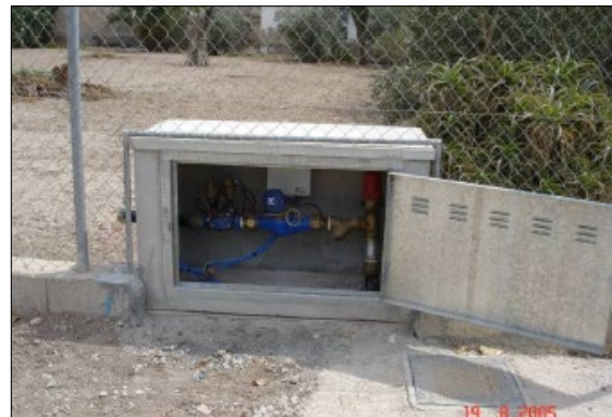
Ilustración 9: Hidrante. Fuente: Dept. Tec. CGR
