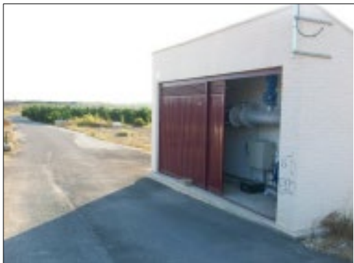
Ilustración 8: Cámara de las instalaciones de cabecera del Sector 8 del Segundo Canal de Levante. Fuente: Google Earth y elaboración propia
