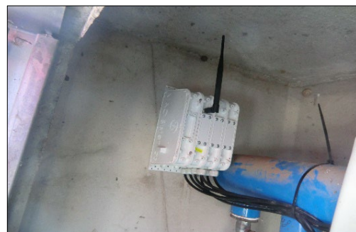
Ilustración 11: Ejemplo de unidad remota instalada en el interior del hidrante
