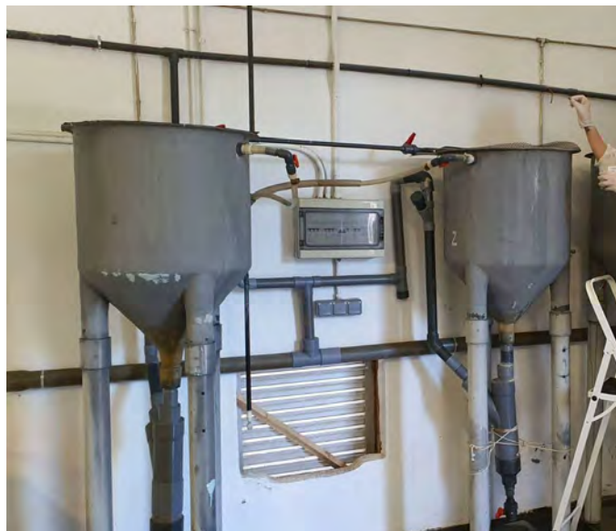
Foto.33. Detalle de los tanques de digestibilidad, donde se llevaron a cabo las pruebas de digestibilidad y excreción
