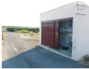
Ilustración 11: Cámara de las instalaciones de cabecera del Sector 8 del Segundo canal de Levante. Fuente: Google Earth y elaboración Propia
