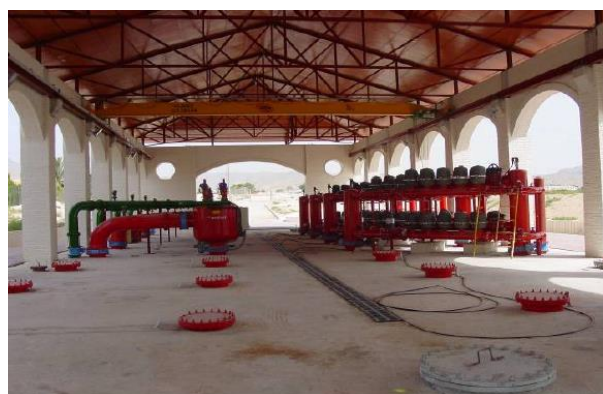
Ilustración 7: Estación de filtrado. Fuente CGR
