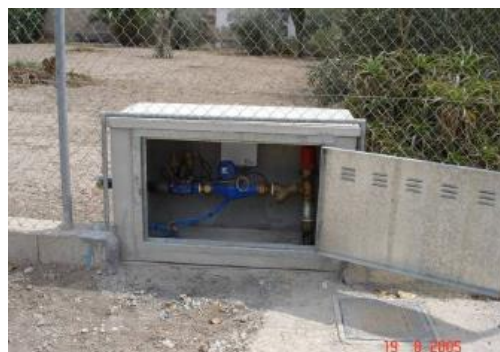
Ilustración 13: Hidrante. Fuente: Dept. Tec. CGR
