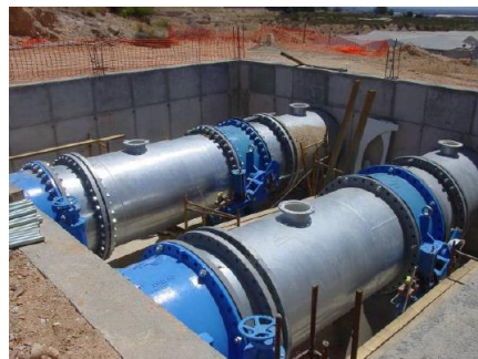
Ilustración 5: Conducción general 2 x PRFV1600 y válvulas de sobre velocidad. Fuente: Dept. Tec. CGR
