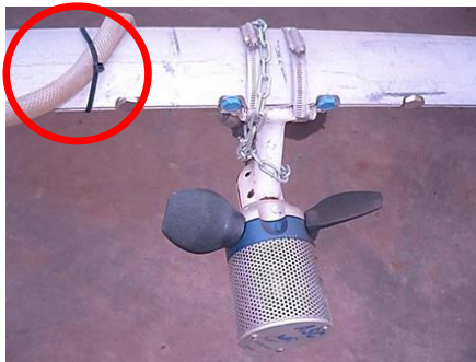
Tubería aplastada en el perfil de la pértiga que dificulta el paso de líquido hacia la boquilla centrifuga
