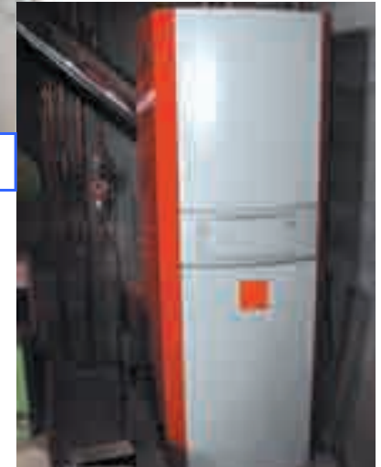
CALDERA DE AGUA CALIENTE
