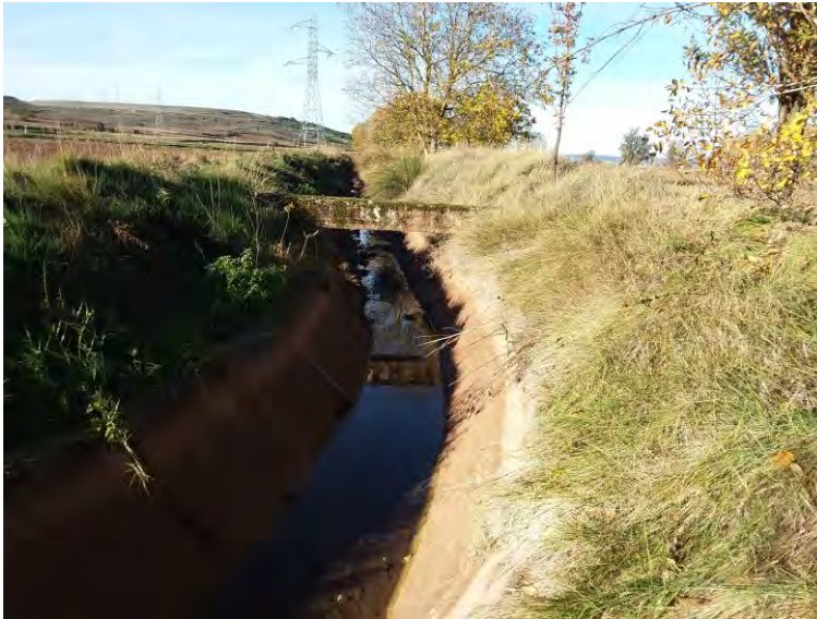
Tramo de Canal a reparar
