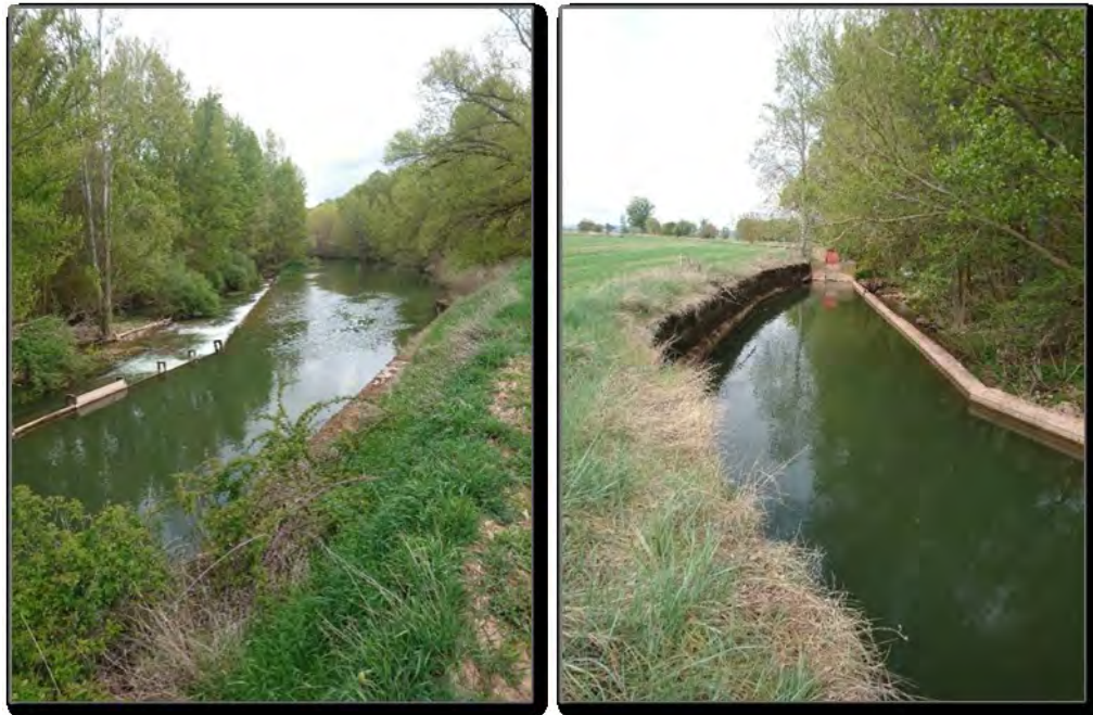
Captación sobre el río Arlanza. Azud, término municipal de Peral de Arlanza (Burgos)
