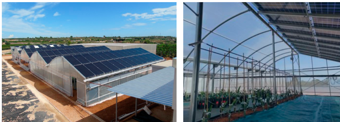
Figura 44. Instalación Picassent Solar (Valencia)
