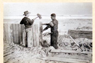
Colocación del tablestacado para formar la duna litoral o contraduna y detener en la playa la arena que continuamente arroja el mar en ella. 1901. Guardamar del Segura. Alicante. Francisco Mira.
